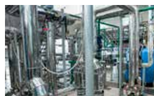
工艺管道系统
