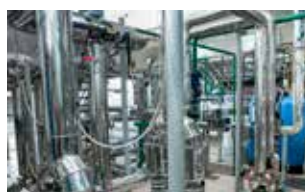
工艺管道系统
