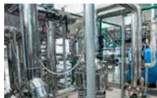
工艺管道系统
