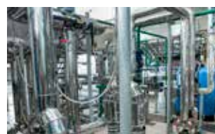
工艺管道系统
